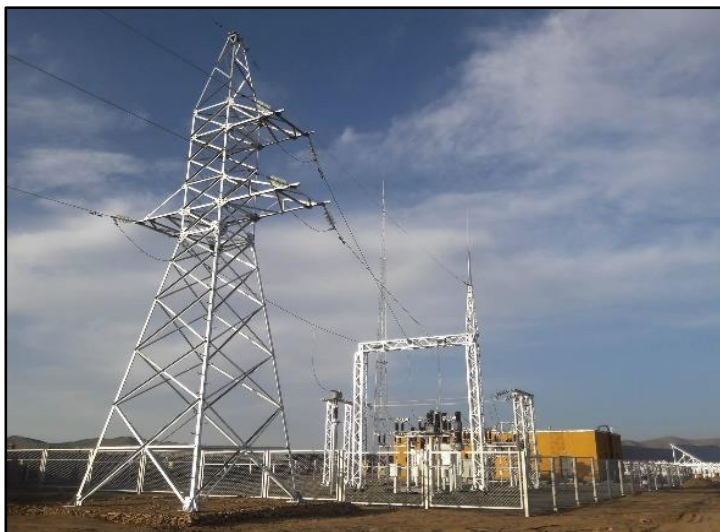
35кВ Дэд станц
